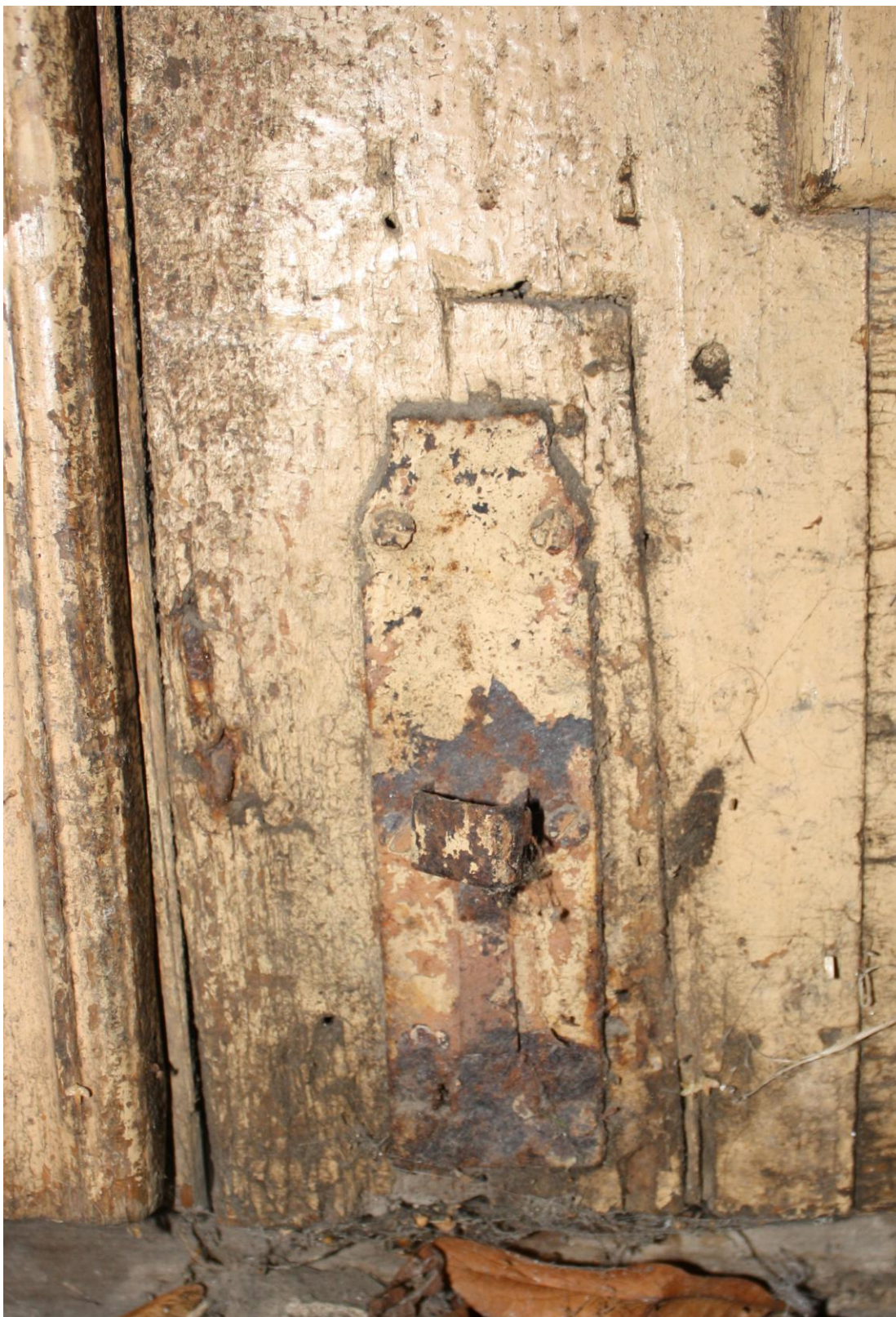
Durvju vērtnes apakšējais fiksators, kas laika gaitā aizstājis sākotnējo fiksatoru. Tas jāizgatavo jauns pēc esošā augšējā fiksatora analoga
