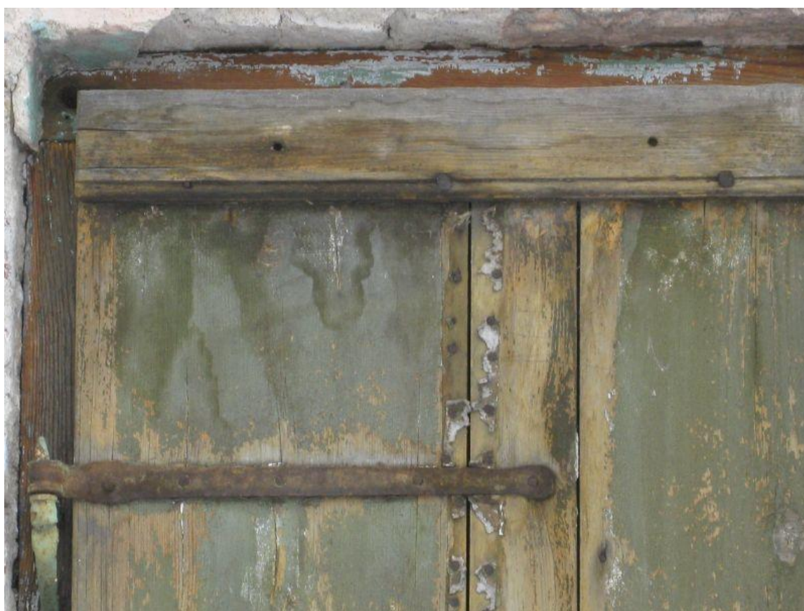
29.att. L2 slēģu vērtnes S3 detaļa. Vēlāk ar naglām un ādu noblīvētas plaisu vietas, tas demontējams.
